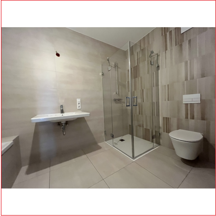
Bad mit Wanne und Dusche
